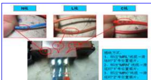
Figura 9 Conexiones de los cables
