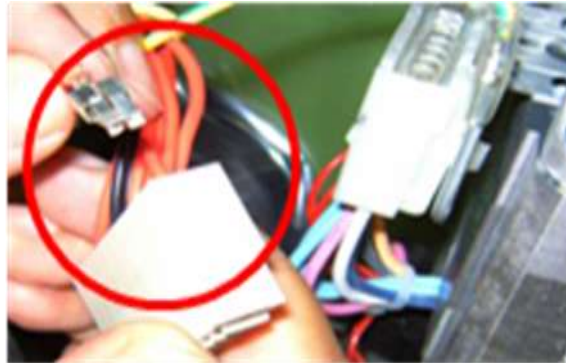
Figura 7 Comprobación del conector del motor
